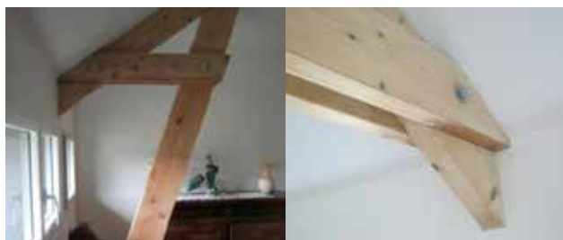
Fuite entre la charpente et le doublage : Le bois et le doublage sont deux éléments qui « travaillent » avec le temps. Cette fuite due au craquellement du joint s'intensifie d'autant plus avec le nombre d'éléments traversants.
