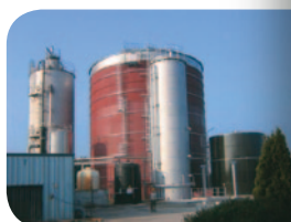
Digester de 7 000 m 3
