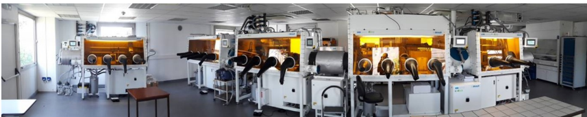
Nouvelles boîtes à gants installées à Saft Bordeaux—Saft
