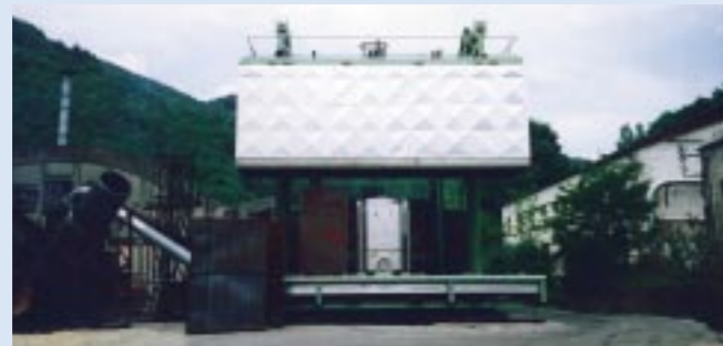
Four utilisant le procédé de thermolyse pour le retraitement des déchets bois industriels
